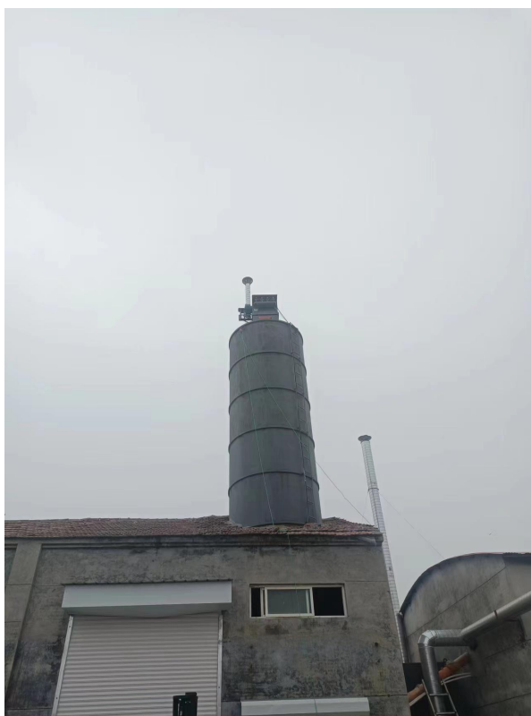
图 3-1 筒仓脉冲式布袋除尘器
