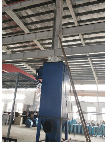
图 7-2 P2 中间除尘器（布袋除尘器）排气筒进口
