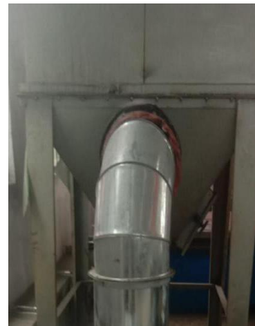
图 7-3 P4 西边南侧除尘器（布袋除尘器）排气筒进口
