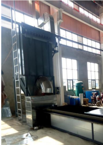
图 7-1 P1 东侧除尘器（布袋除尘器）排气筒进口
