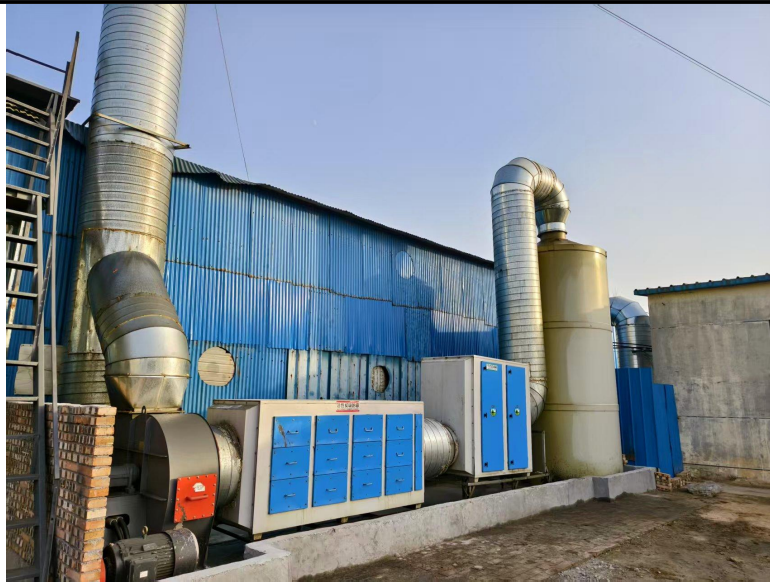
图 3-2 “喷淋塔+干式过滤器+活性炭”处理设施
