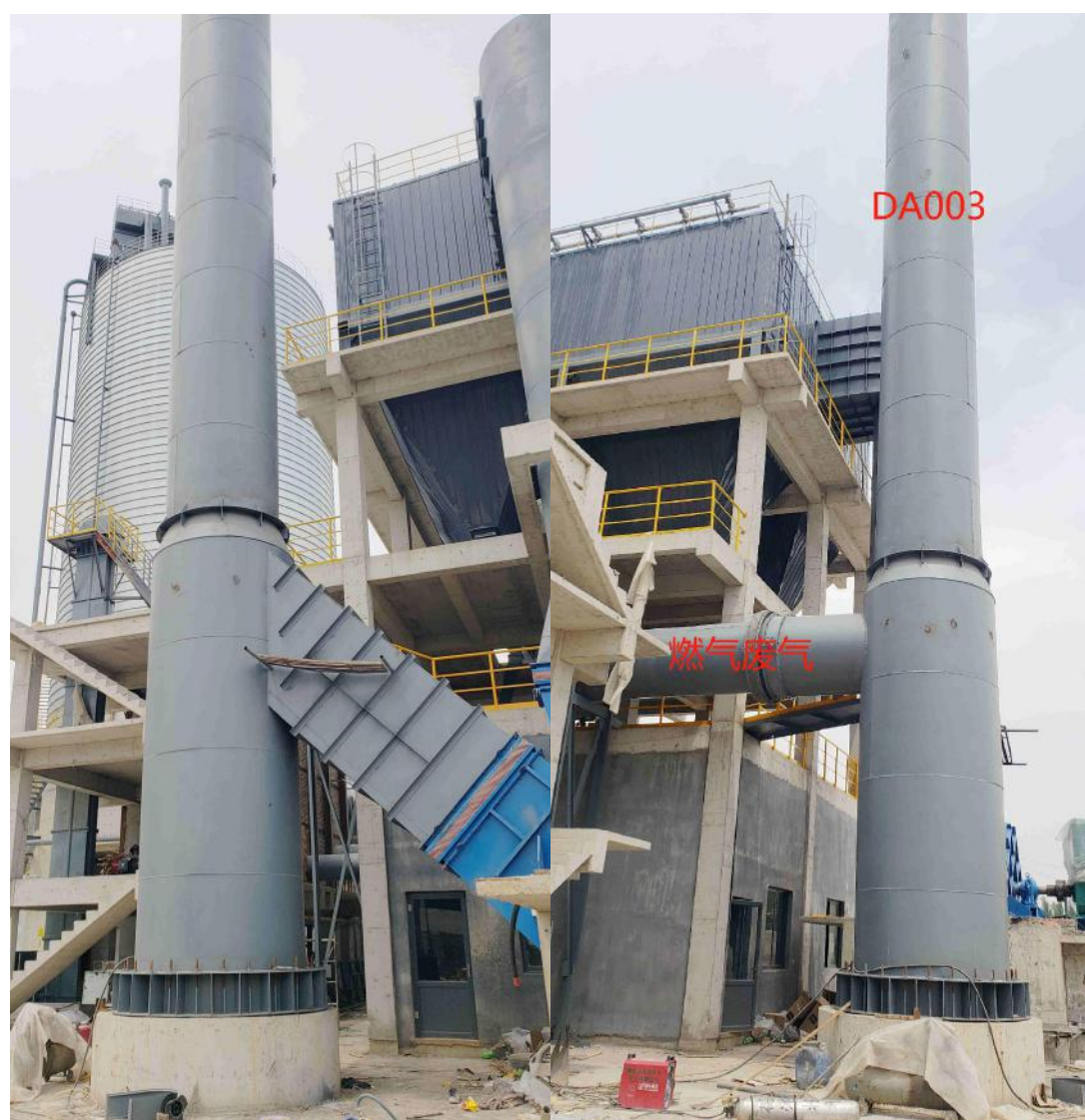
图 3-6 超细研磨粉生产线立磨除尘器排气筒
