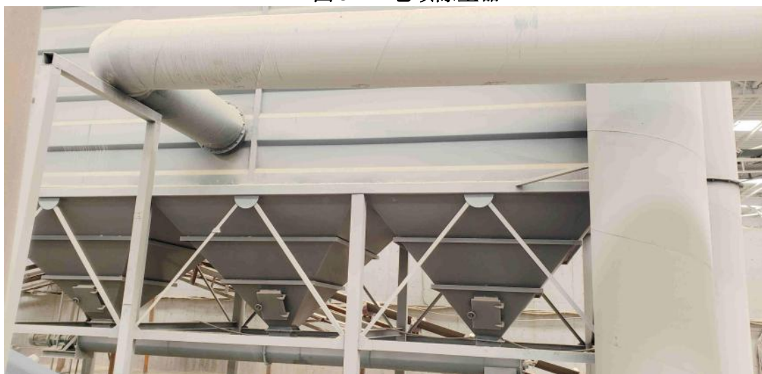
图 3-2 再生砂石除尘器
