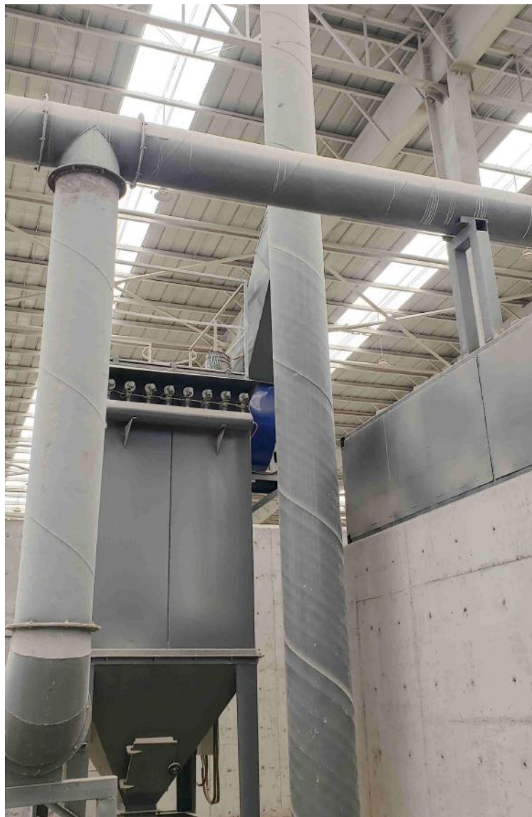
图 3-4 水泥稳定碎石生产线除尘器和排气筒
