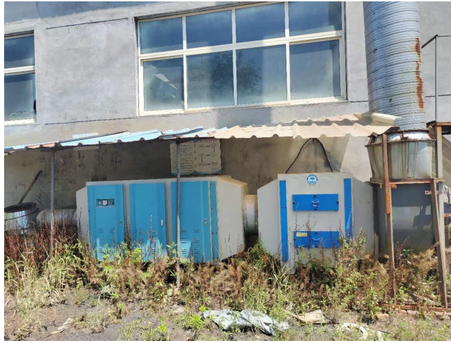
图 3-2 废气处理设施
