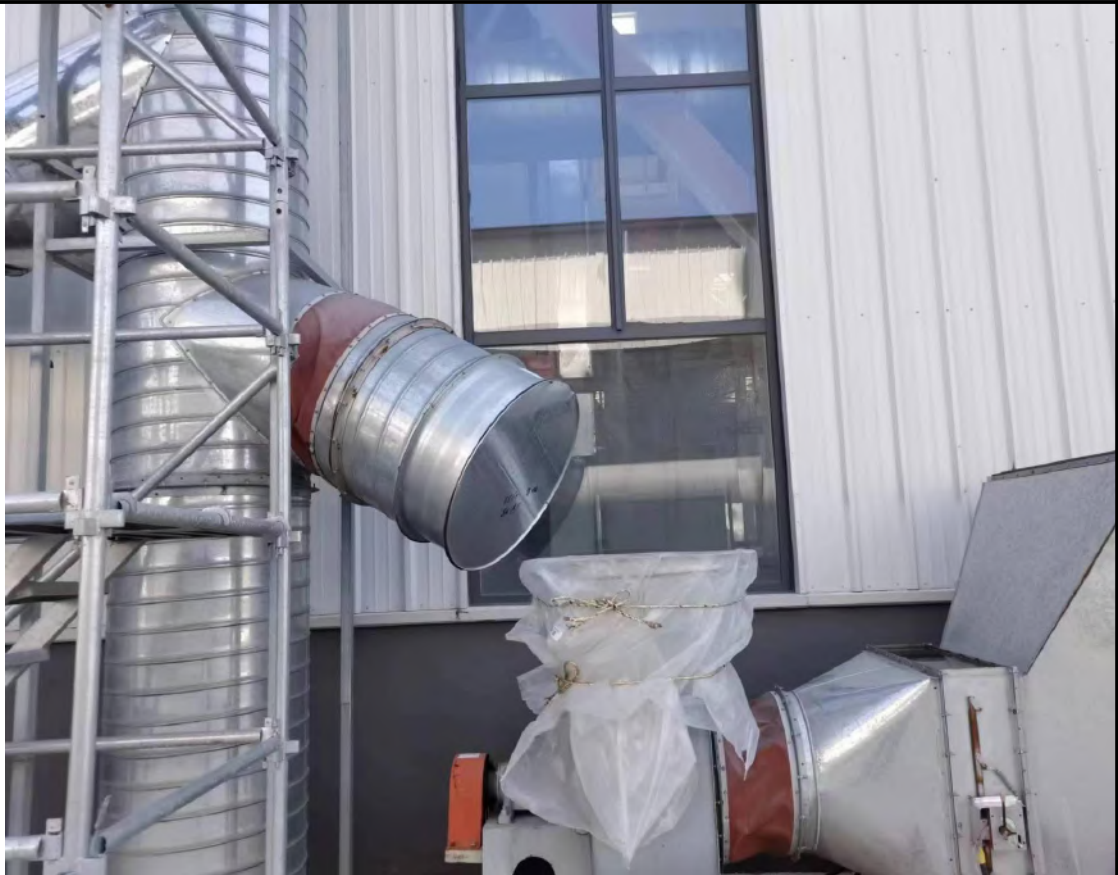
图 3-5 废气处理设施以新带老（原有工程有机废气活性炭吸附装置处理停用，调整为依托本项目催化燃烧设备处理）
