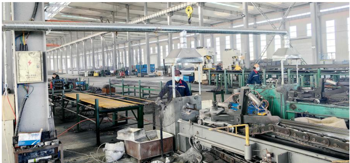
图 3-2 拉拔工序集气罩及收集管道
