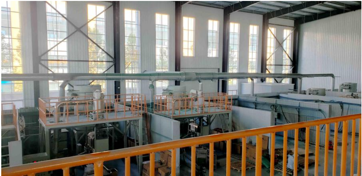
图 3-3 磨粉工序废气收集
