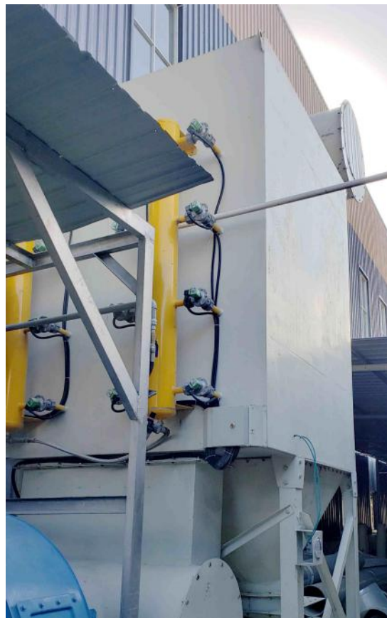
图 3-5 配料混合、切碎工序除尘器
