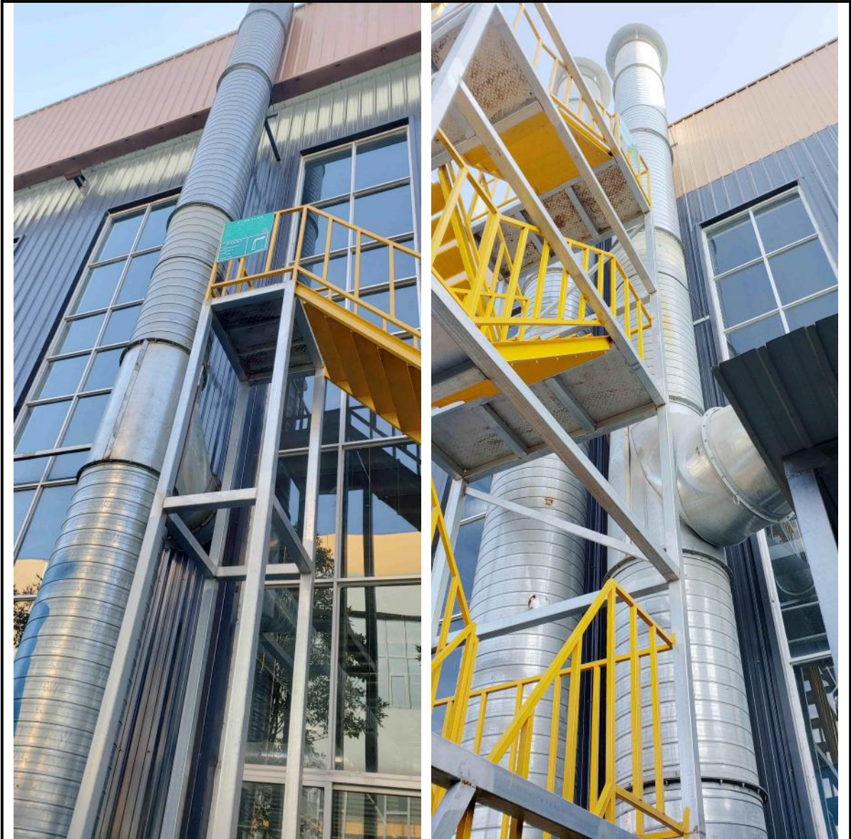
图 3-8 排气筒和采样平台
