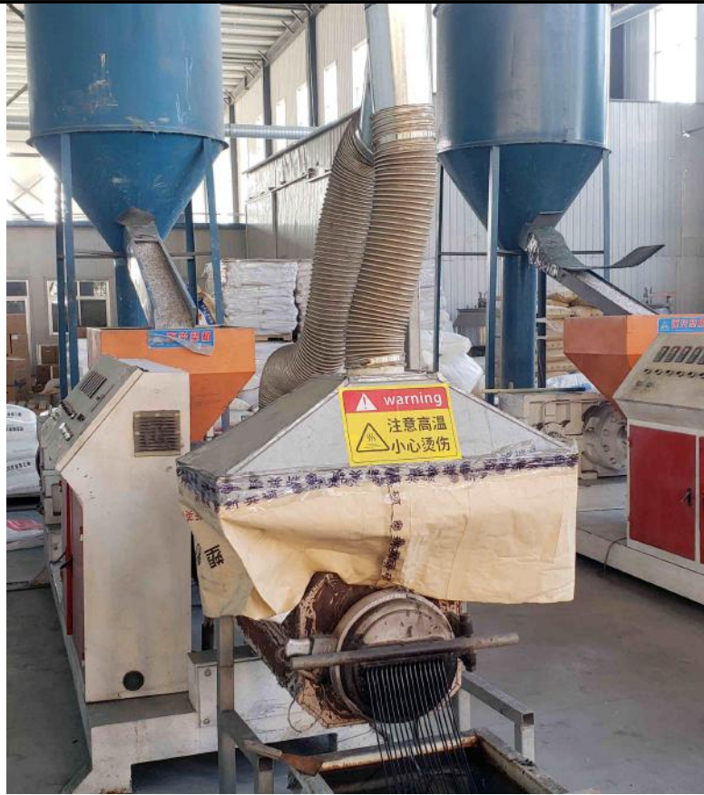
图 3-6 挤出工序废气收集
